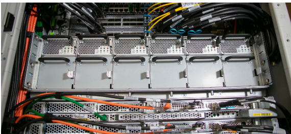
圖三- AWS Outposts 交流對直流電源供應器和匯流排條配電
